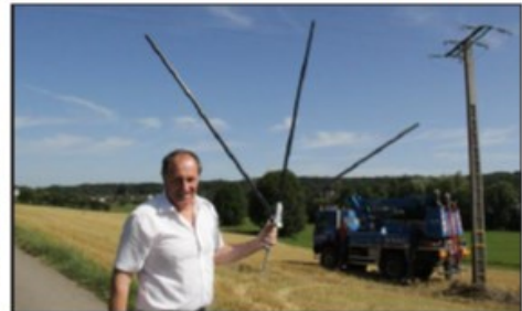
Bernard Bubendorf montre ici l'une des protections qui, installées sur les poteaux, ne permettront plus aux cigognes de nidifier. Afin de protéger les cigognes de Durmenach et alentours, Enedis a consenti un investissement de 10 000 €. Photo L'Aisace
